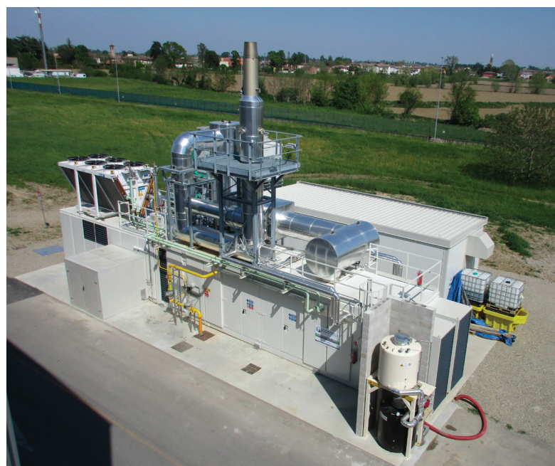
Impianto di trigenerazione per Intercos.
